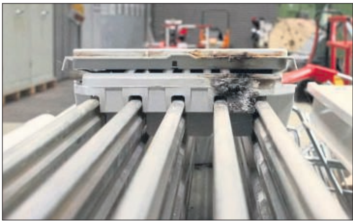
Das Corpus Delicti: Eine durchgeschmorte Stromschiene liegt zur Untersuchung im Pumpenhaus der Schleuse Esterholz.
